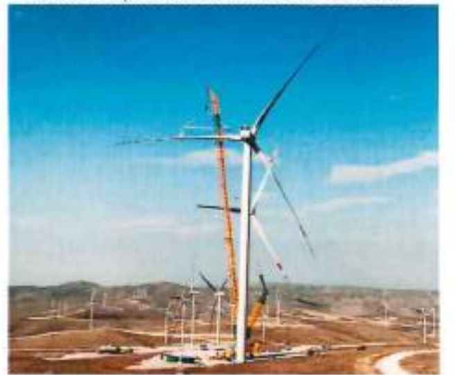
BAĞLAR RÜZGAR ENERJİ SANTRALİ PROJESİ
