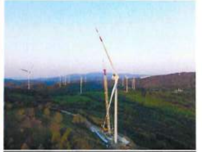
BALIKESİR ŞAMLI RÜZGAR ENERJİ SANTRALİ
